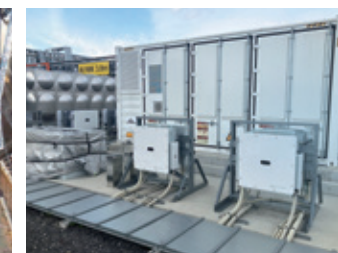
蓄電システム
