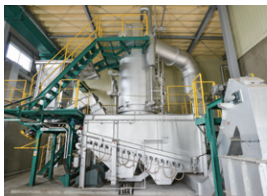
バイオマスボイラ
