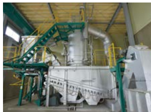
バイオマスボイラ
