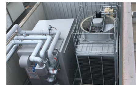
冷却用冷凍機
